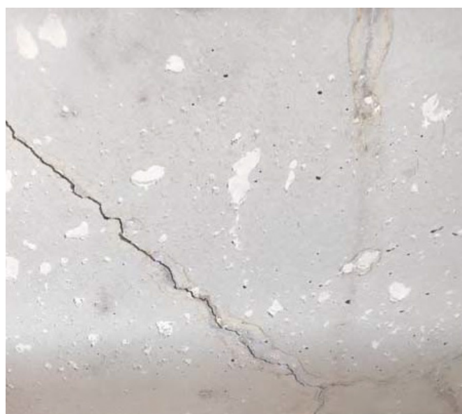
Una vez finalizado el proceso con P17 se han formado microcristales en el interior de la piscina que atajan la pérdida de agua.
