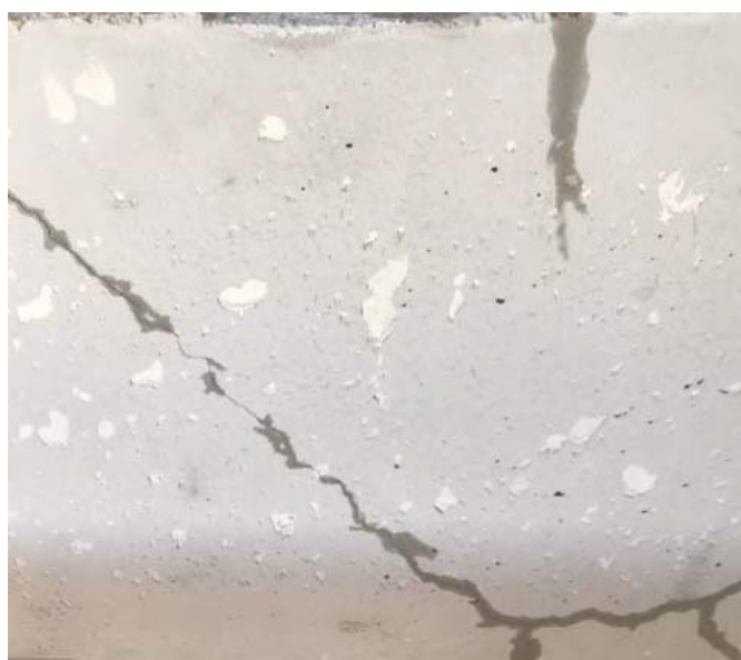
Hormigón con micro-fisuras que provocan pérdidas de agua de nuestra piscina o depósito.
