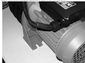
FALSCH! Wasser gelangt über das Kabel in den Anschlusskasten
